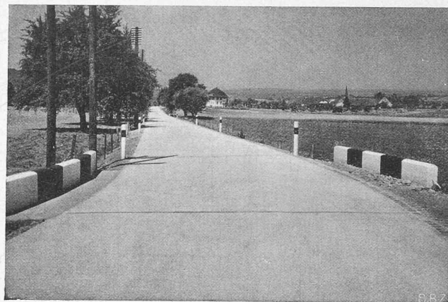
Abb. 9. Betonstrasse Stein a. Rh. - Schaffhausen. Betonbelag 5,7 m breit (Einzelheiten vergl. „S. B. Z.“ Bd. 96, Seite 40).
