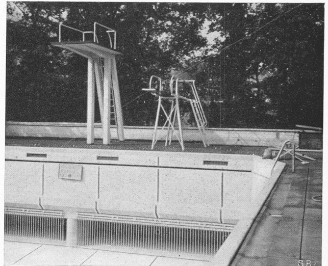
Abb. 12. Wellenaustritt am Tiefende des Schwimmbeckens.
