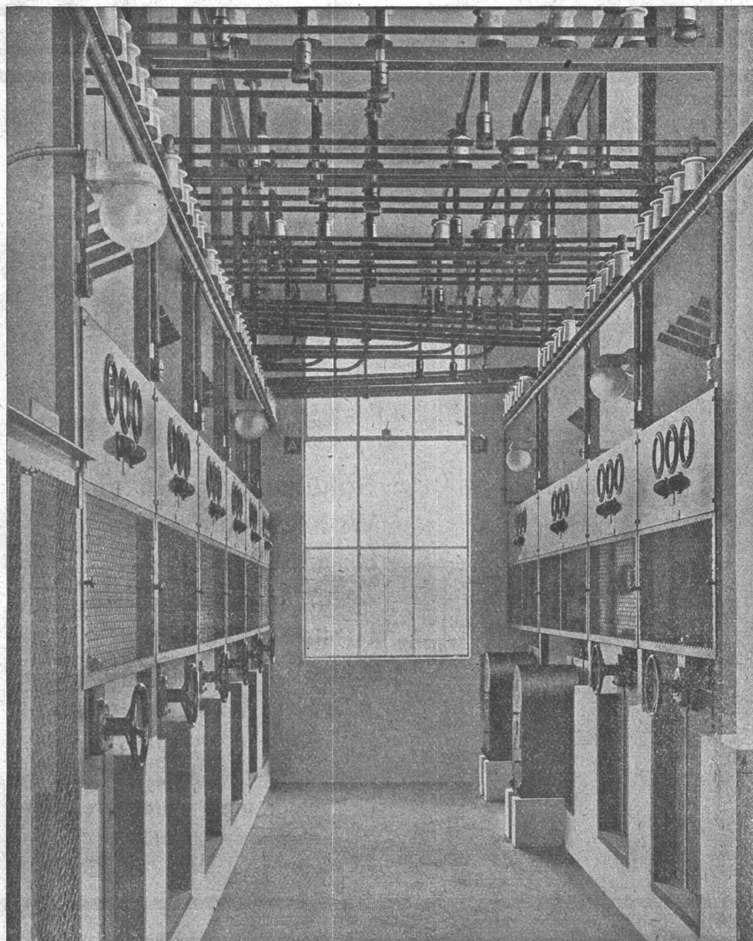
Transformatorstation 6300/3295 V. 50. Elektrizitätswerk der Kraft und Licht A.-G., Belgrad.
