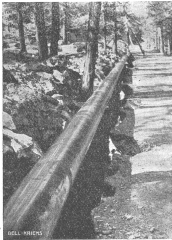
Elektrisch geschweisste Druckleitung der Wasserversorgung Samaden (Länge: = 9 km, Lichtweite: = 350/400 mm, statischer Druck: = 20 atm.). Erstellt 1933.
