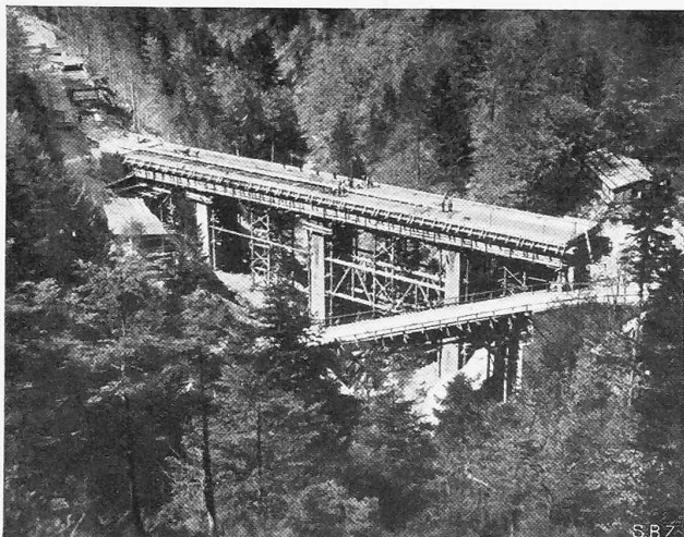
Abb. 2. Bucherbrücke der Deutschen Alpenstrasse, im Bau. Durchlaufender Eisenbetonbalken über 4 Oeffnungen von 15,2 + 21,4 + 21,4 + 15,2 m, 2 Hauptträger von 2,2, bzw. 2,4 m Höhe, 0,42 m stark, ohne Vouten, dafür an den Auflagern auf 0,72 m verbreitert. Trägerabstand 5,7 m, Fahrbahn 9 m breit.
