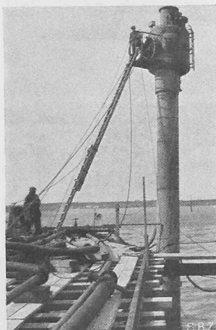
Abb. 11 Absenkung des westlichen,
