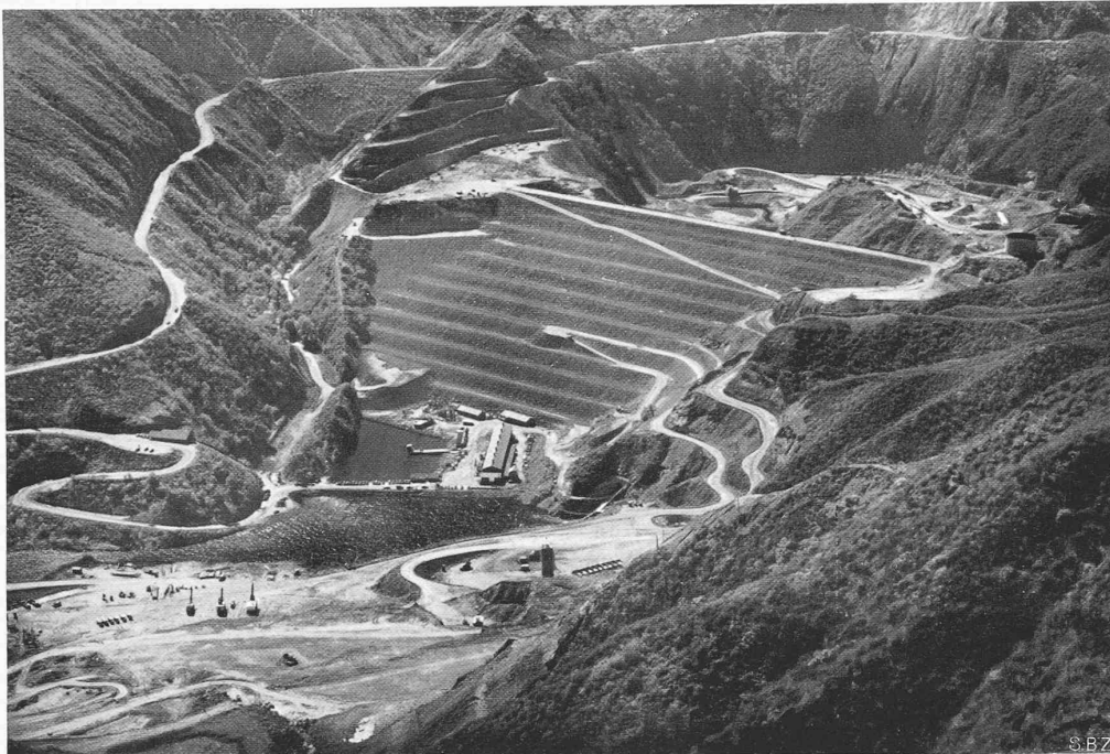
Abb. 6. Der vollendete Damm von der Luftseite, Juli 1937. Aushub des Entlastungs-Ueberfalls Im Vordergrund der Steinbruch
