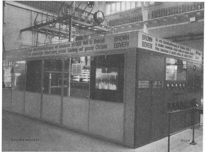
Gleichstrom-Kraftübertragung Wettingen-LA mittels Mutatoren. Umformung des ankommenden Gleichstroms in Drehstrom.
