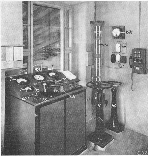
Abb. 21. Führerstand I. Sektion. — A Amp., V Voltmeter, T Tachometer, WS u. WA Wagenstellungsanzeiger, SL Signal-lampe für Oelschalter, H Handbremse, HO Handantrieb des Oelschalters, WM Windmesser (vgl. ferner Legende zu Abb. 19)
