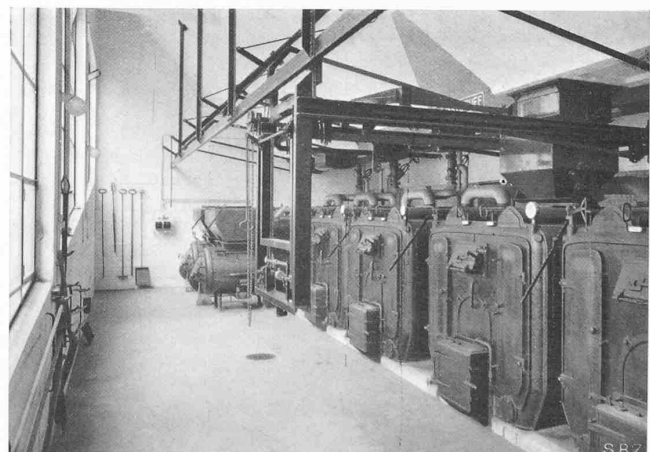
Abb. 20. Heizung mit Beschickungs-Laufkran verbunden mit Waage
