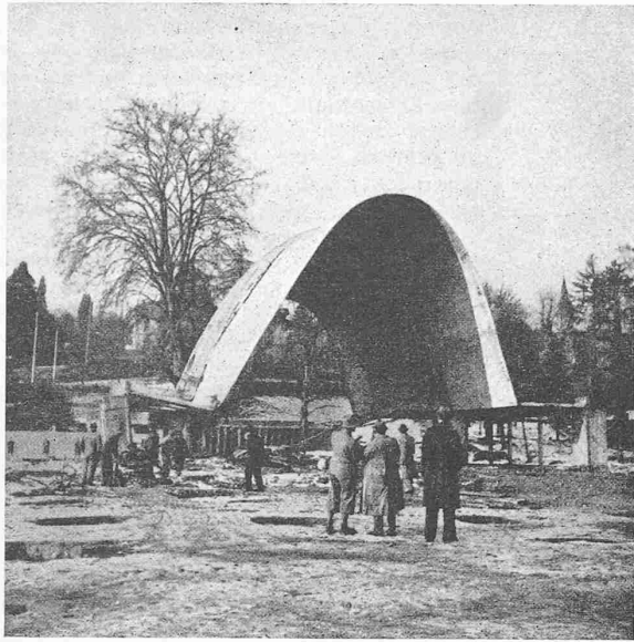
Abb. 9. Umreissen der Halle durch Horizontalzug an einem Rippenfuss nach links vorn: Lösung der Schale von der Rippe
