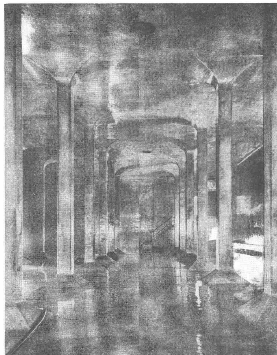
Wasser-Reservoir Käferberg der Stadt Zürich Inhalt 5000 m 3 Erbaut 1941
