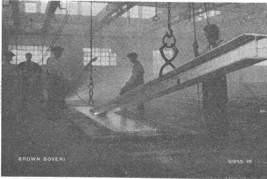
Elektro-Wannenofen für Feuerverzinkung von Röhren und Profilen. Das flüssige Zinkbad hat eine Länge von 8 m und 0,72 m Tiefe; Temperatur 460° C. Anschlusswert 120 kW.
