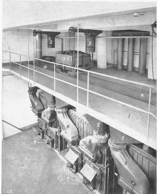
Abb. 29. Taschenkessel von Gebr. Sulzer. 1 Bedienungspodest, 2 Siloausläufe. 3 Rollwagen mit Waage, 4 Einfüllöffnungen der Tagesbunker 5, 6 Schwenkarme, 7 Unterwindgebläse
