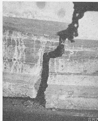
Abb. 23. Bruchstelle des Balkens Zerstörung durch Zerreißen der Stahlröhre
