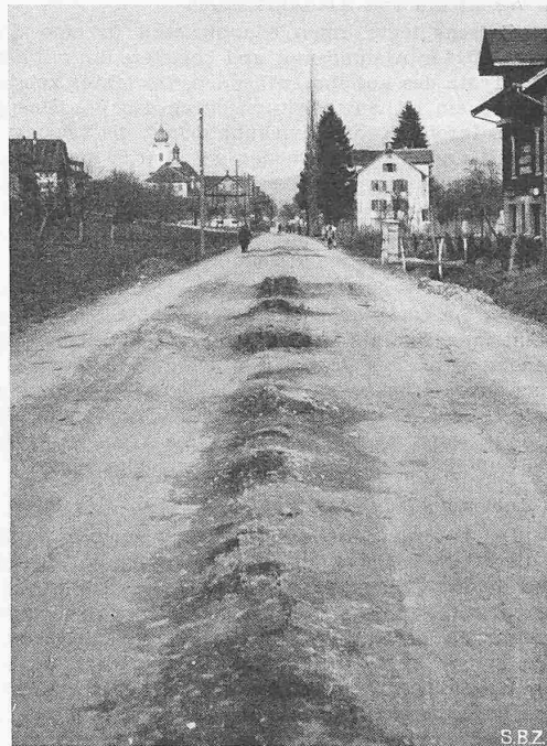
Abb. 3. Frostschäden in Bitumenoberflächenbehandlung südlich Ebikon. Fahrbahn längs den Fahrspuren eingedrückt und in der Mitte hochgequetscht. Zustand nach Eintritt von Tauwetter (Phot. Kant.-Ingenieur O. Enzmann, Luzern)
