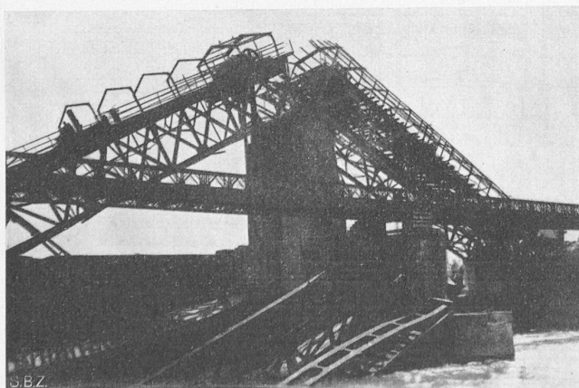
Bild 1. Oeffnung 5, am deutschen Ufer, von Unterwasser. Dammbalken, Strassenbrücke, Schützen, Windwerksbrücke sind zerstört. Bailey-Brücke an Stelle der gesprengten Strassenbrücke
