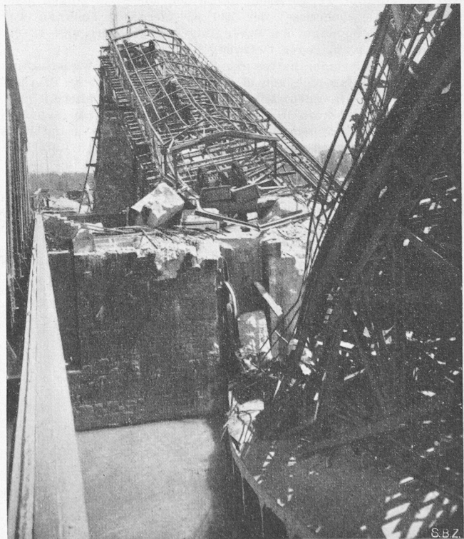
Bild 2. Pfeiler III von der Strassenbrücke aus gesehen: links (hinten) Oeffnung 4, rechts (vorn) Oeffnung 3
