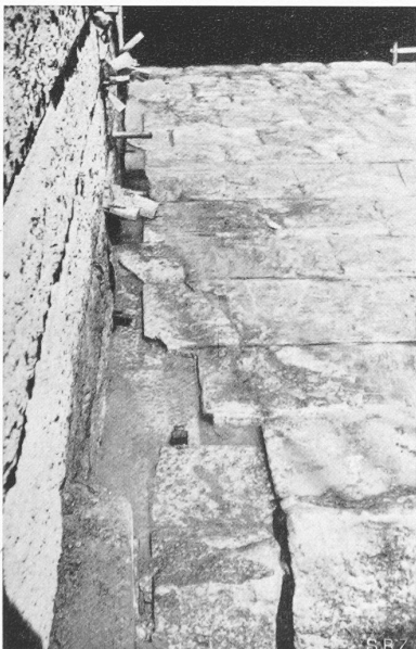
Bild 26. Schubriss in der Wehrschwelle längs linkem Widerlager. Die Querfuge im Vordergrund zeigt das Mass der Längsverschiebung
