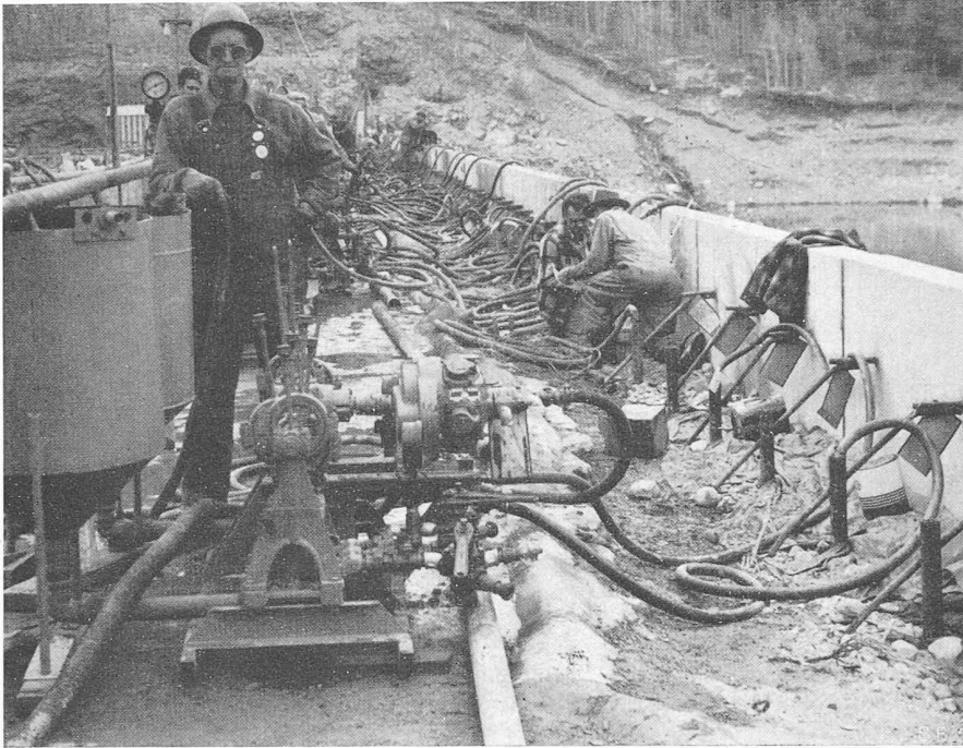
Bild 5. Mauerkrone während des Einfüllens des Mörtels. Links Zwischenbehälter für Mörtel, darüber Mörtelzubringerleitung, daneben Mörtelpumpe mit Druckluftmotor für den Antrieb, darunter Anschlussstutzen für die Schläuche. Rechts: Enden der vertikalen 2" Mörtel-Einfillrohre mit hineingesteckten Schläuchen, dazwischen Inspektionsrohre
