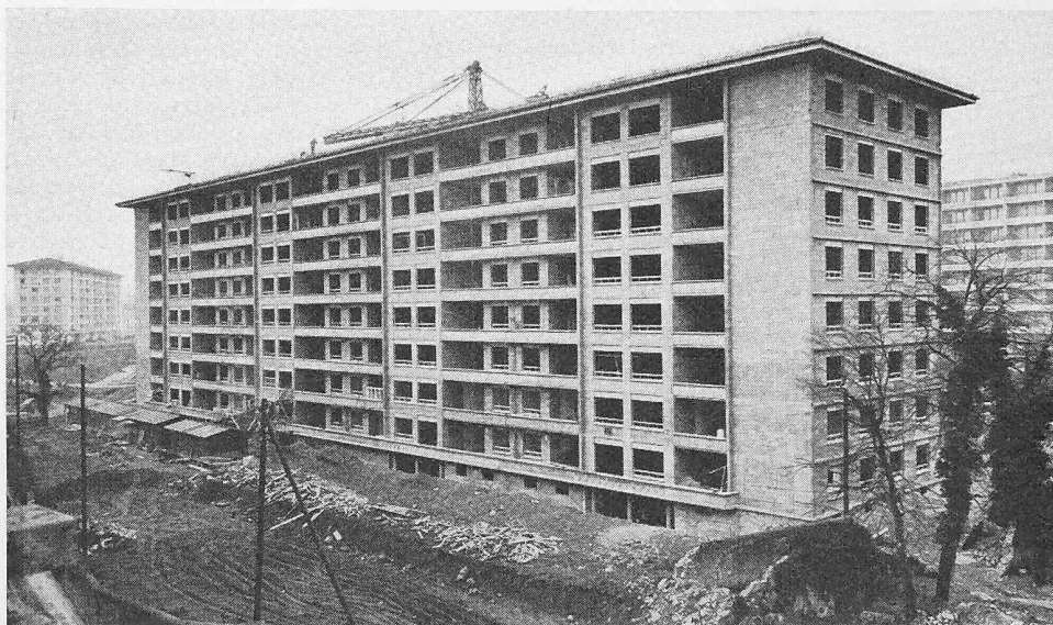
Bild 6. Neunstöckiger Wohnbau in Genf, skelettlose Ausführung mit tragenden Durisol-Mauersteinwänden, Architekt F. JENNY, Zürich
