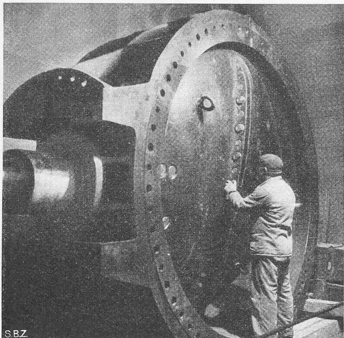
Bild 25. Die Drosselklappe, \varnothing 270 cm, im Wasserschloss Handeckfluh
