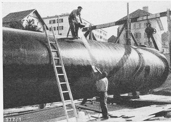
Bild 8. «Vetro-Waberit»-Isolation eines der zwei 150 000 Liter-Oelbehälter der Stadt Le Locle (Strassenbaumaterial AG. Bern)
