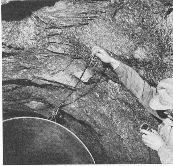
Bild 10. Schweissnahtprüfung im Druckschacht. Die Strahlenquelle aus Ir 192 wird am Ende der Stahlrute zwischen Rohr und Fels eingeführt
