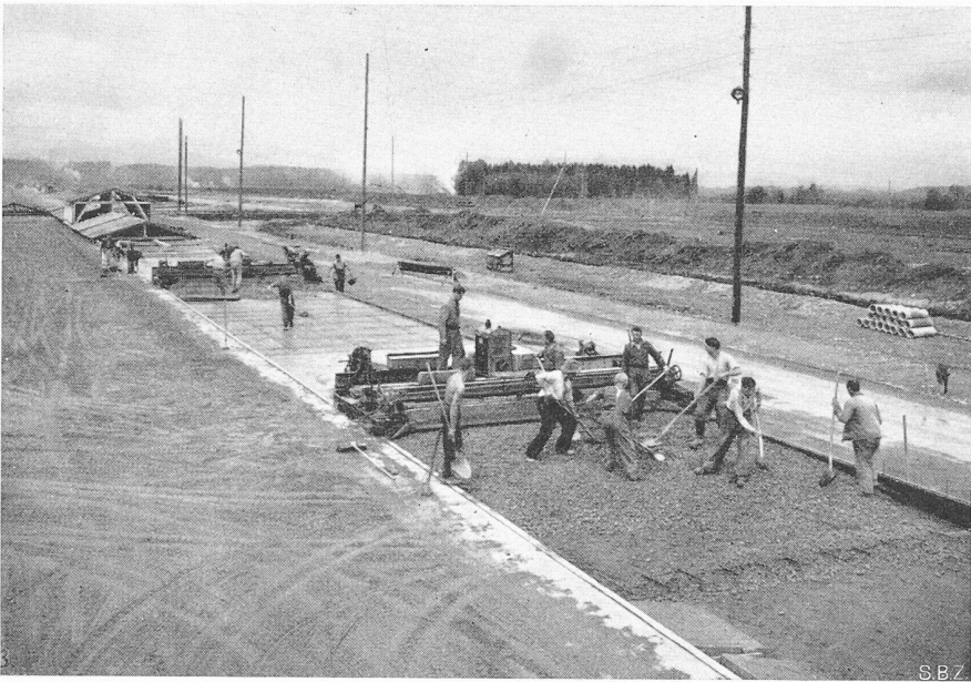
Bild 19. Betonieren der Betonbeläge auf der Westpiste. Im Vordergrund Einbau der unteren Betonschicht, dahinter verlegte Netzarmerung und Einbau der oberen Betonschicht
