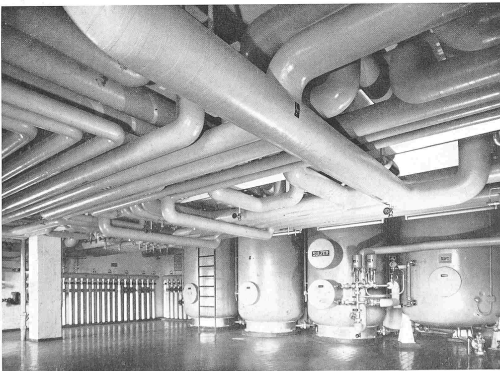
Rohrraum unter dem Pumpen- und Apparateraum, drei Warmwasserspeicher und ein Kondensatspeicher
