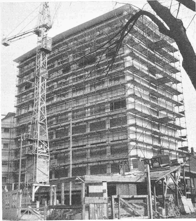
Bild 2. H-Rahmen-Fassadengerüst in Zürich
