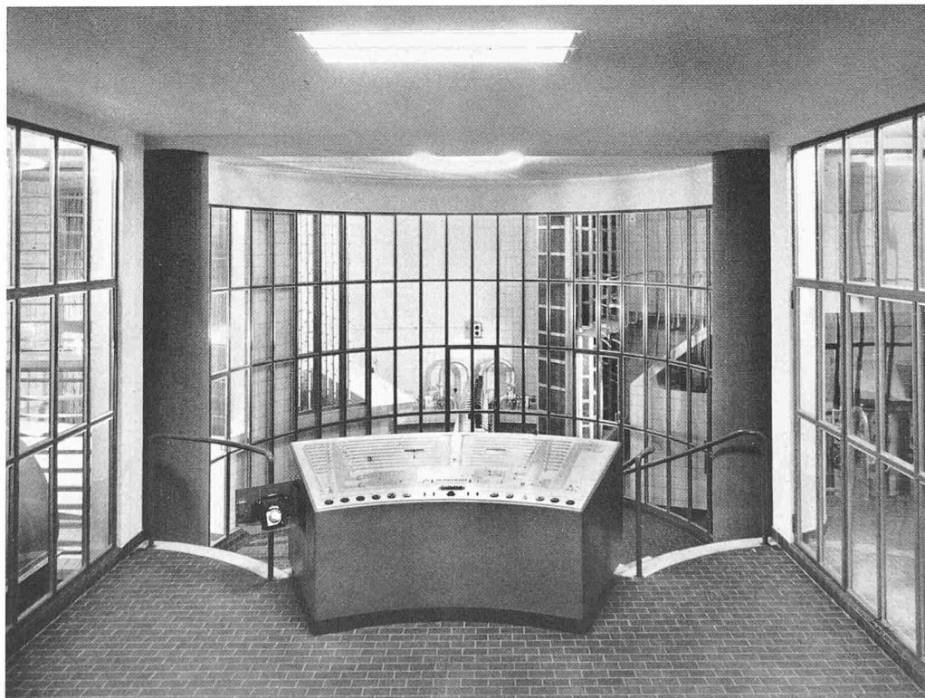
Zentrale Klimaanlage, Kommandopult
