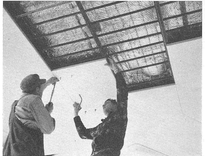
Bild 2. Hohlräumheizung mit Gipsplattendecke (Isolog, Zürich)
