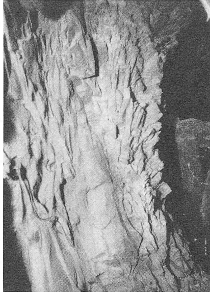
Bild 5. Fortschreitender Bruch der westl. Ulme nach der Stollenerhöhung, Km 9,743 ab Nordportal
