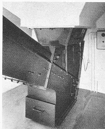
Bild 6. Abzug unter dem Koksbunker. Die Vibrationsrinne und das Förderband sind staubdicht verschalt. Staub und Kleinkorn sammeln sich in der Schublade
