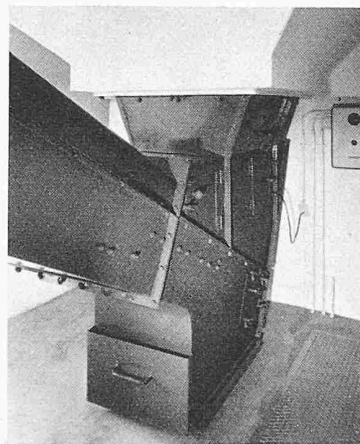
Bild 6. Abzug unter dem Koksbunker. Die Vibrationsrinne und das Förderband sind staubdicht verschalt. Staub und Kleinkorn sammeln sich in der Schublade
