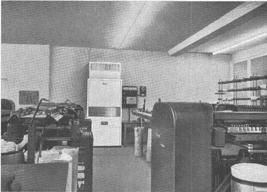
Klimagerät in einem Arbeitsaal der Textilindustrie
