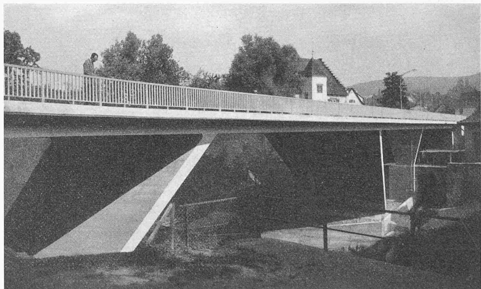
Bild 1. Untersicht der neuen Birsbrücke in Dornach vom linken Ufer, mit den Streben des Sprengwerkes und der Pendelstütze über den Kanaleinlauf
