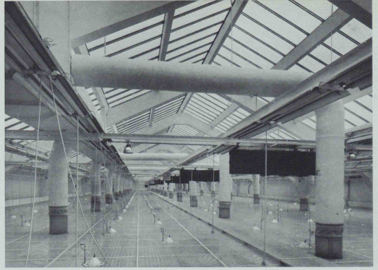
Dachraum mit Beleuchtungs- und Belüftungs-Installation; unten Ausstellungssaal
