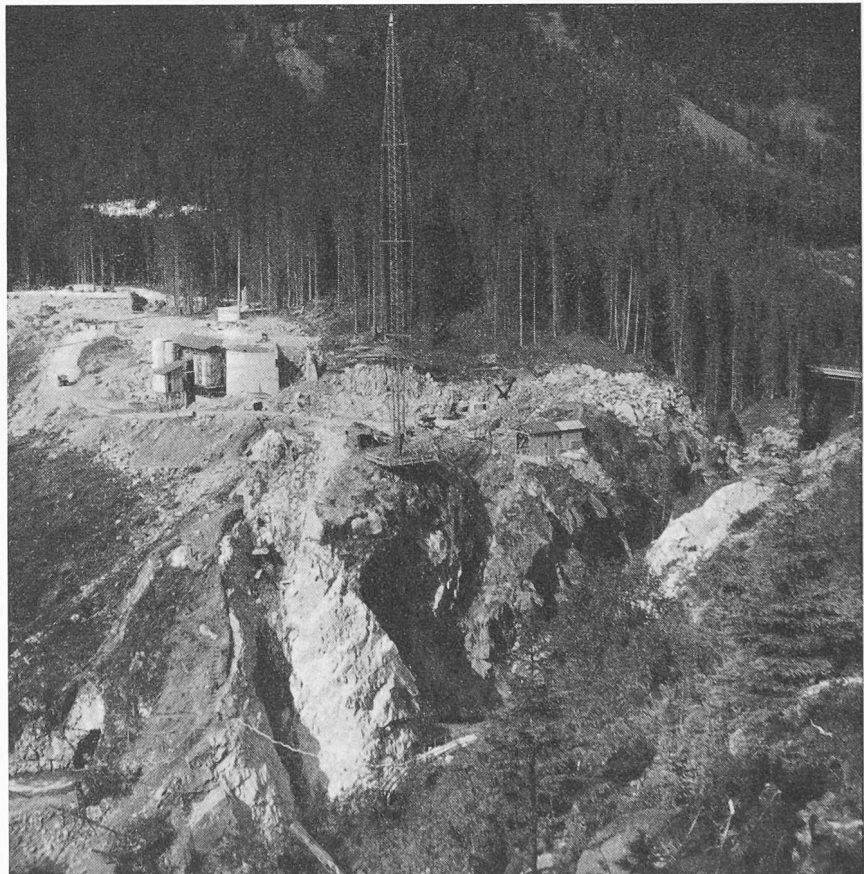
Bild 1. Sperrstelle Sufers aus Süden, Anfang Juli 1960. Im Vordergrund der linksufrige Fundamentschlitz für die Bogenmauer in der Hinterrheinschlucht. Links der Einlauf des Umleitstollens. Auf dem Crestawaldrücken der 6-t-Derrick mit 60 m grösster Ausladung für die Staumauerbetonierung. Die Betonmischanlage ist links an einen bereits erstellten Teil der bergseitigen Wand der Hochwasserentlastung angelehnt, deren Ablaufrinne sich im Aushub befindet. Ganz hinten links ein Stück der aus dem Staugebiet verlegten neuen Kantonsstrasse, bis zu welcher sich der niedrige Flügeldamm auf dem Crestawaldrücken erstreckt
