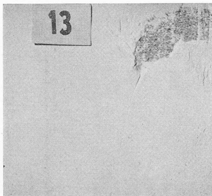
Nr. 13: Schalung ungehobeltes Holz, geölt. Haftung des Gipsmörtels nur mässig
