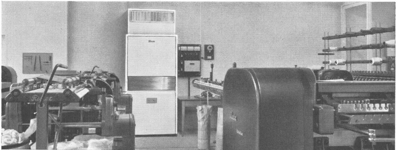
Klimagerät in einem Arbeitssaal der Textilindustrie
