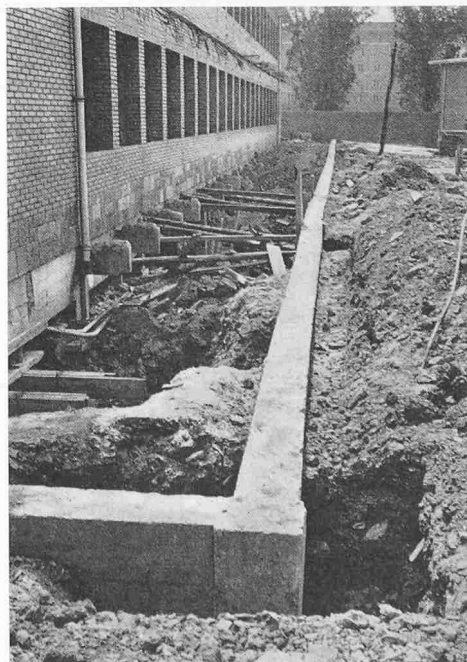
Fig. 4. Déformations horizontales d'une poutre. Puits de reconnaissance
