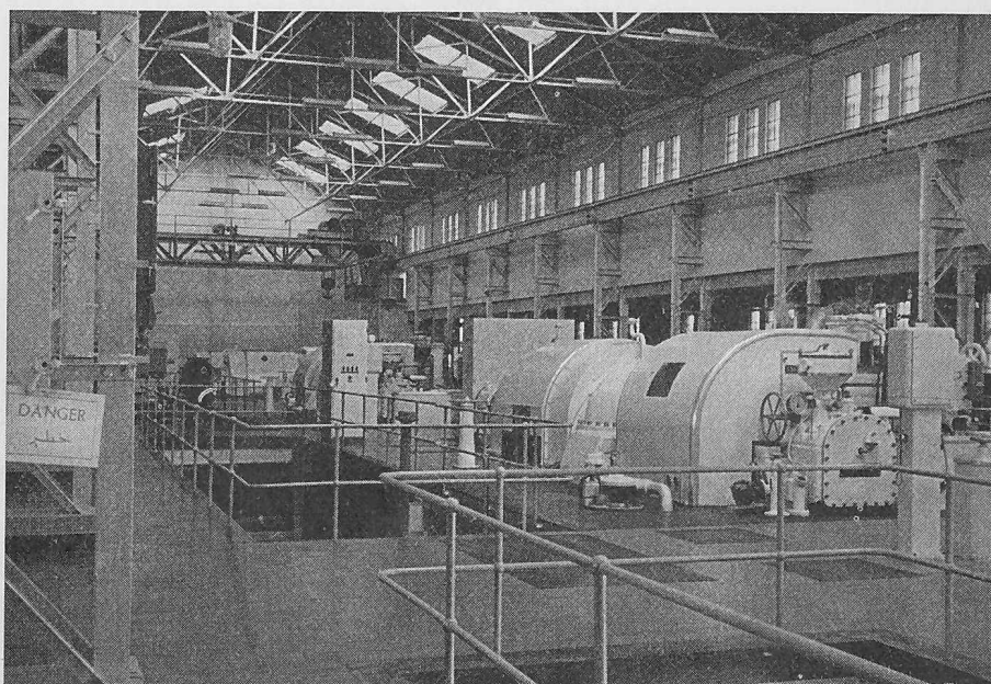
Bild 6. Kraftwerk Burri, neue 10-kV-Einheit
