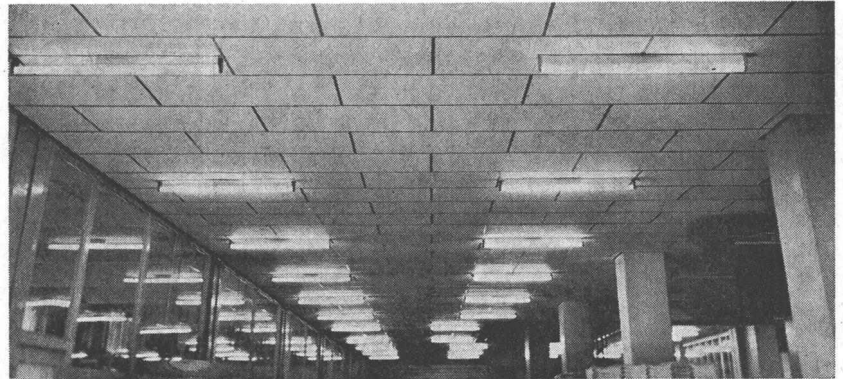
ungelochte Schallschluckplatte, unbrennbar, hier mit sichtbarem Hängerost in einem Druckereisaa
