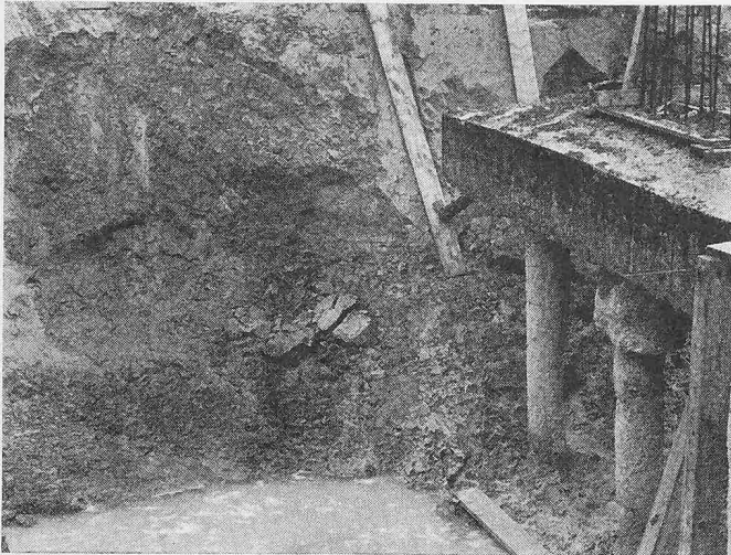
Bild 9. Freigelegte Pfahlgruppe, ungleiche Ausbildung der Pfähle, Risse
