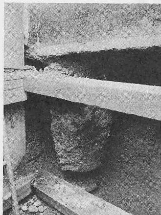
Bild 11. Oberer Teil des Pfahles fehlt überhaupt
