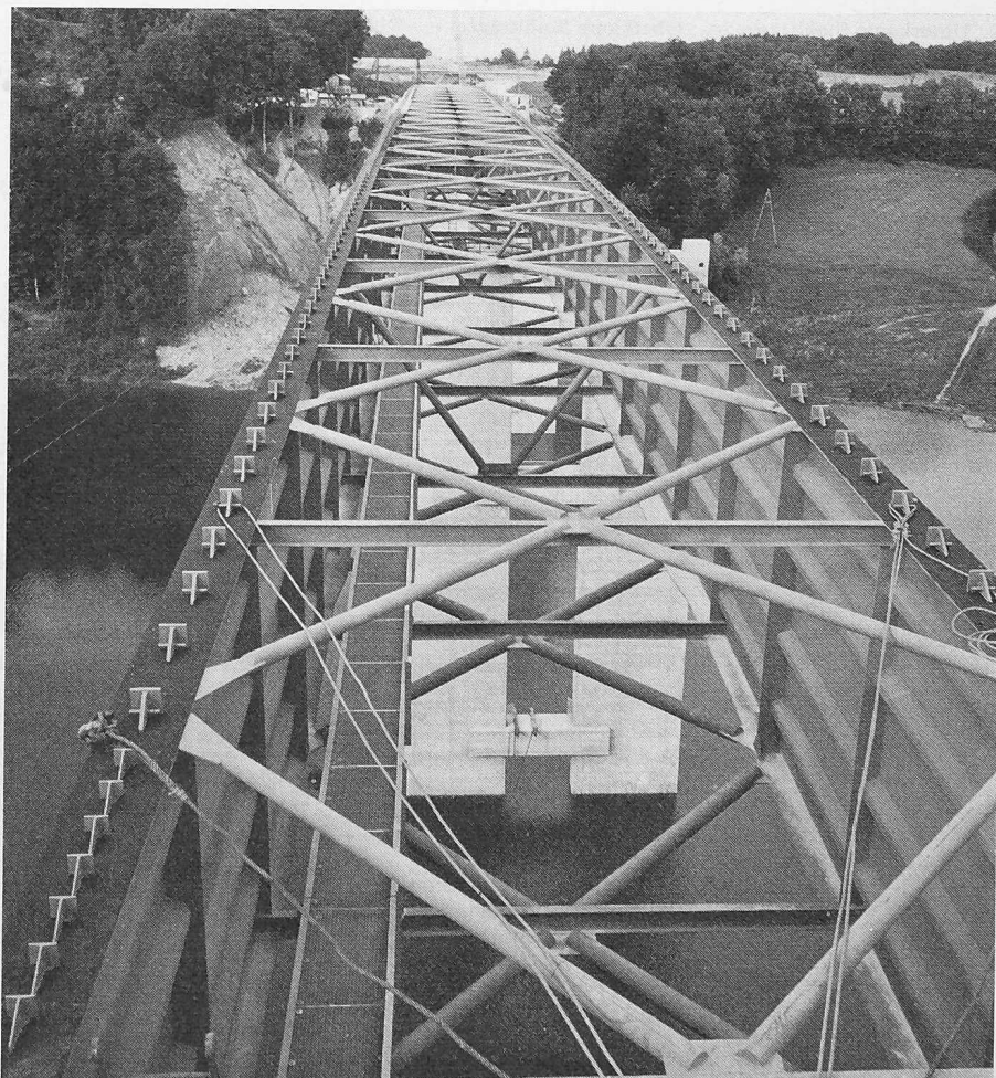
Bild 8. Draufsicht nach Abschluss des Einschlebens, vom linken Widerlager aus aufgenommen. Die Anordnung der Windverbände und die Dübelverteilung sind gut sichtbar
