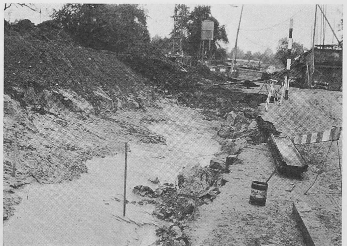
Bild 7. Ausschwemmungen an einer geschichteten Wechsellagerung Silt — Feinsand unter Moräne, vor dem Anlaufen der Sanierungsmassnahmen. Andwilerstrasse nördlich von Mettendorf
