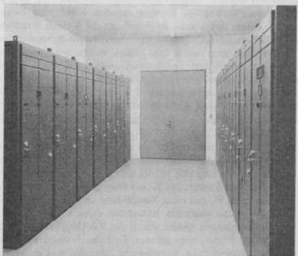
Bild 16. 10-kV-Hochspannungsverteilung in einem Nebenraum der Kältezentrale
