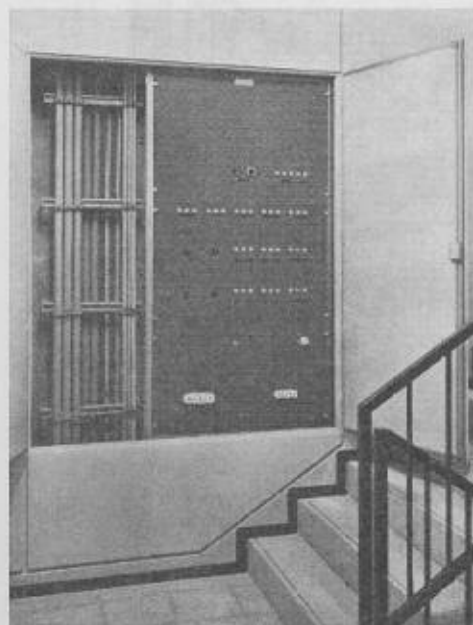
Bild 25. Stockwerk-Unterverteiler mit Steigleitungsschacht
