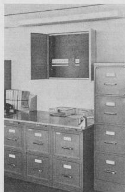
Bild 27. In die Kernwand eingebauter Schützerkasten für Bürobeleuchtung
