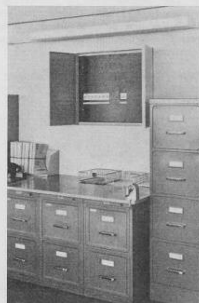
Bild 27. In die Kernwand eingebauter Schützenkasten für Bürobeleuchtung
