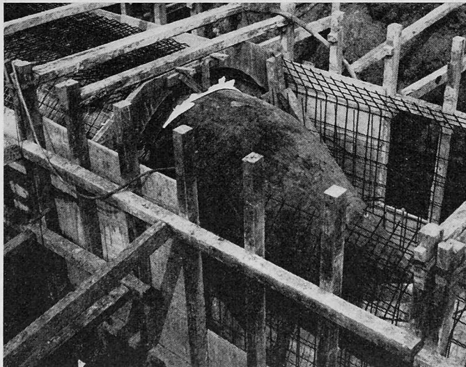
Bild 3. Eia-Gummischalung verlegt und Auftriebssicherung eingebaut. Seitenschalungen gestellt und ein Teil der Scheitelbewehrung verlegt
