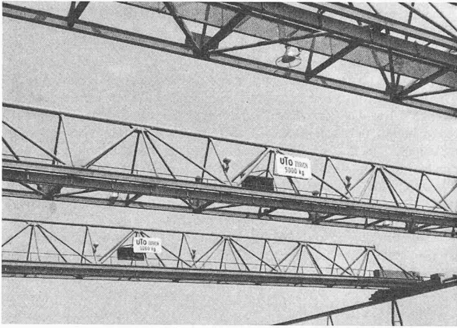
Bild 1. Ansicht einer Radar-Zusammenfahrtsicherung an einer Drei-Kran-Anlage. Die Firmenschilder dienen als Reflektoren
