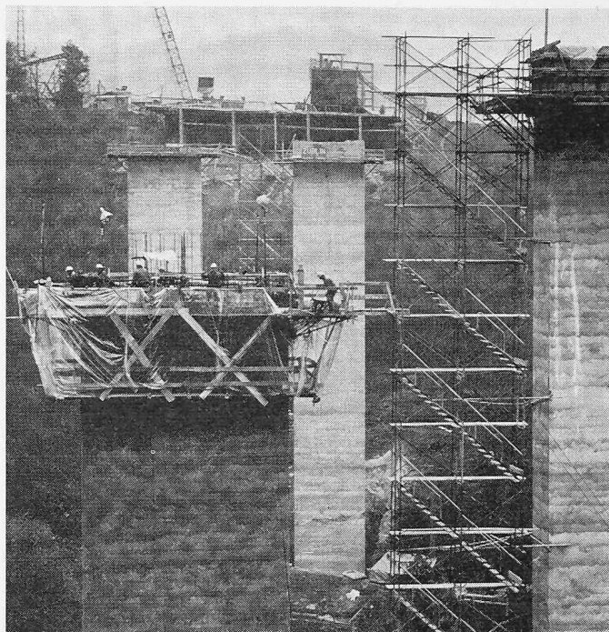
Bild 5. Brückenpfeiler, Kastenquerschnitt 2,20 \text{ m} \times 7,50 \text{ m} , Höhe 50 m. Ziehleistung 5,50 \text{ m}^3 je 24 Stunden
