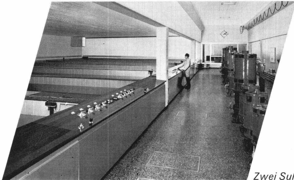
▲ Schnellfilteranlage «Champ-Bougin» der Stadt Neuenburg für das Aufbereiten von Seewasser zu Trinkwasser. Leistung 1800 m 3 /h
