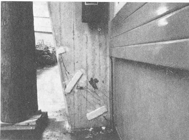
Bild 1. Infolge aussergewöhnlicher Schneemengen geborstener Stützenfuss
