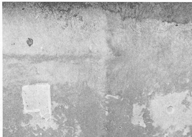
Bild 2. Vorzüglicher Zustand der Stahlunterlage nach dem Ablösen des Schutzsystems auf Epoxidharz-Polyester-Basis mit Glasarmierung nach vier Jahren Lagerung im Grundwasser
